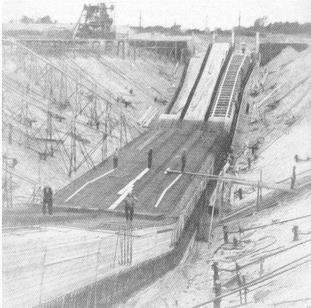
Aanleg van de grondduiker waarmee de Schipbeek onder het aan te leggen kanaal werd doorgeleid.
